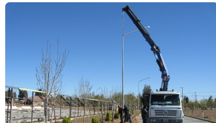
Servicio de mantenimiento cooperativa eléctrica ciudad de Neuquén
