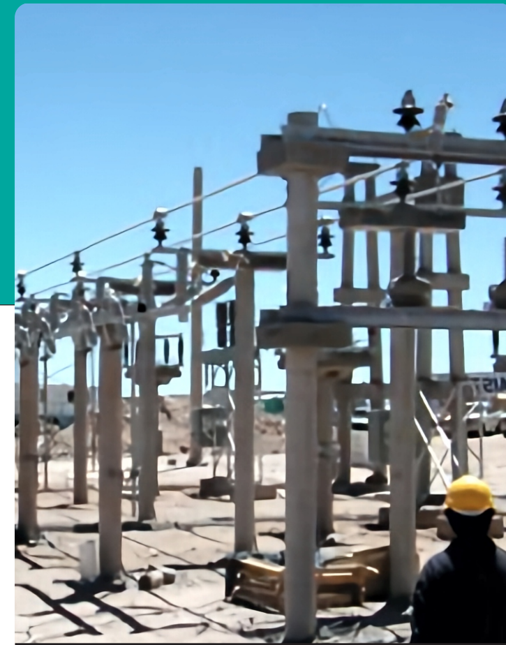
Subestación Rincón de los Sauces
